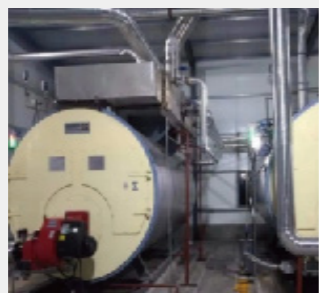
常规燃烧器锅炉
