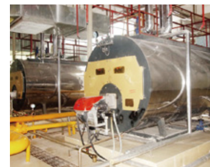
改造前 3台 3t/h，两用一备 占地约 320 m 2
